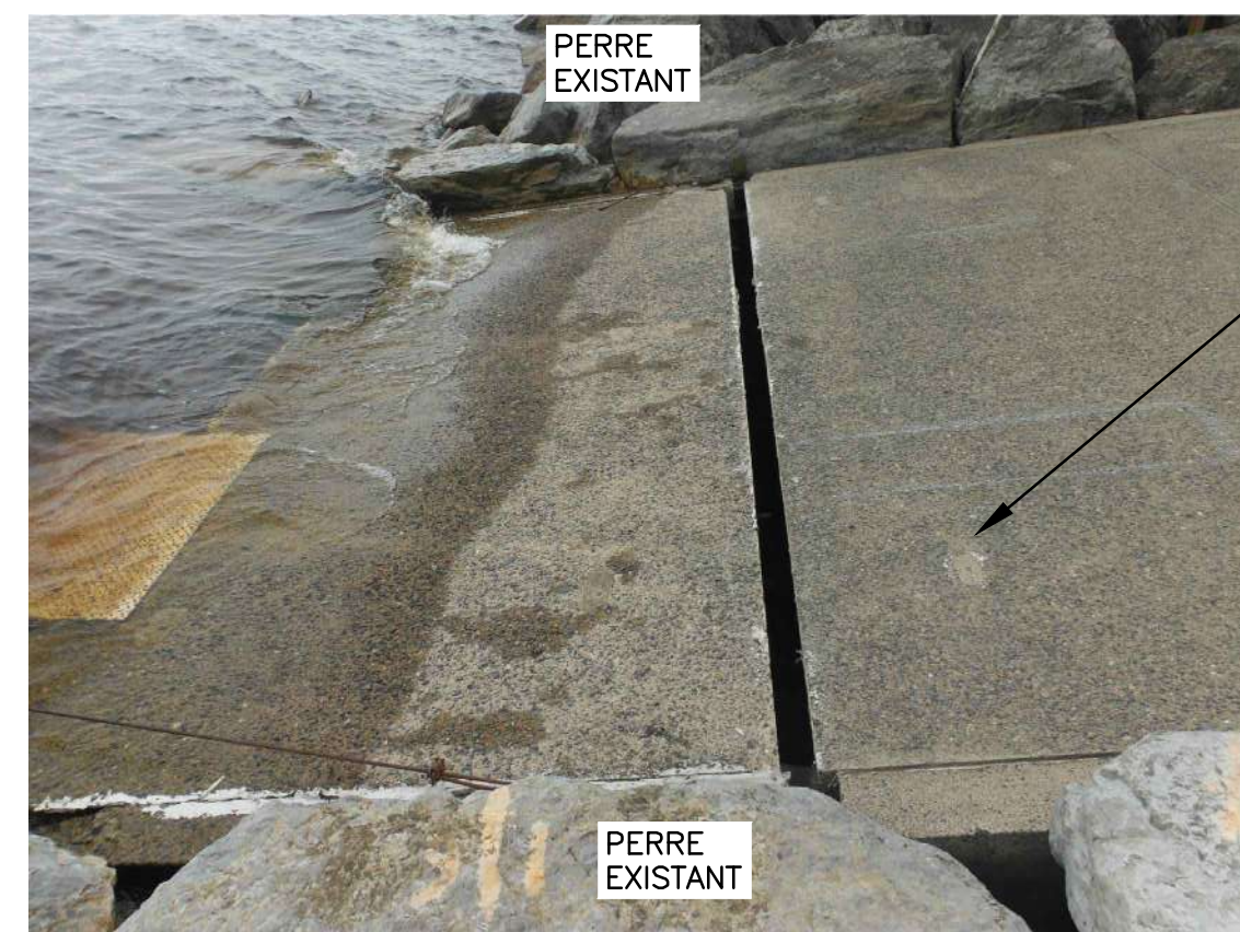
RAMPE RIO TINTO ( A SÉCURISER )
