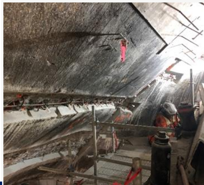
Passage hydraulique – GTA7
