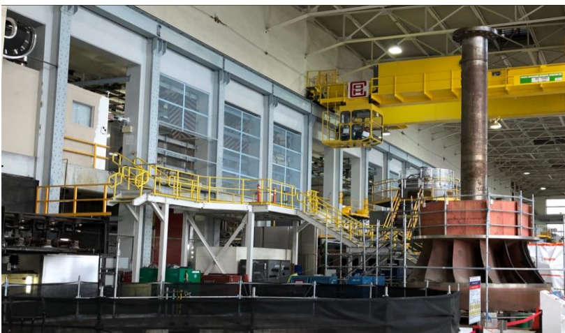
Groupe turbine-alternateur n° 7 démonté (GTA 7)
