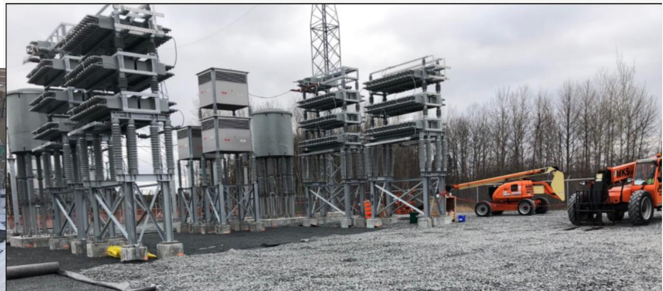
Nouveau banc de condensateur
