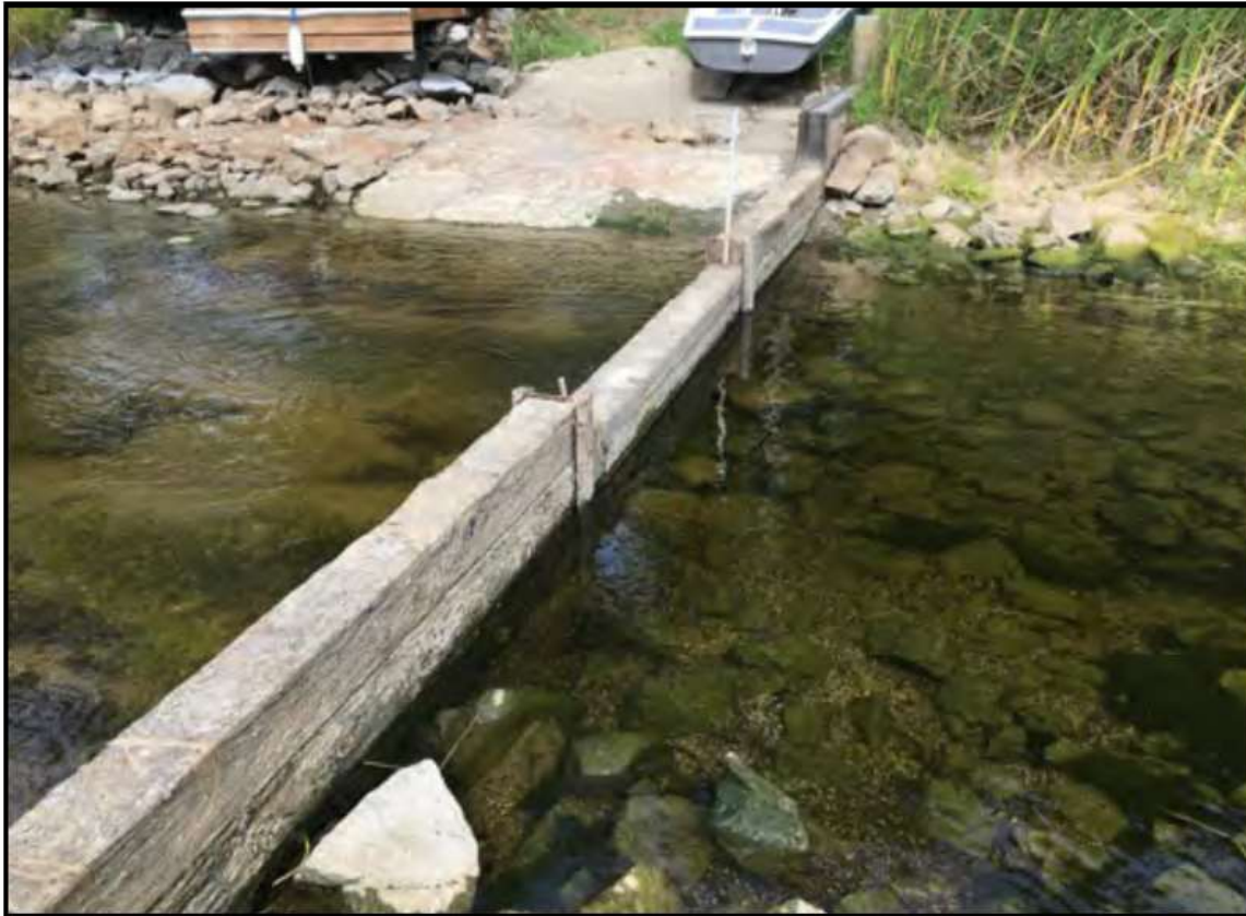
Photo 9. 7 septembre 2021 (100,26 m) Les seuils en bois ne sont plus étanches
