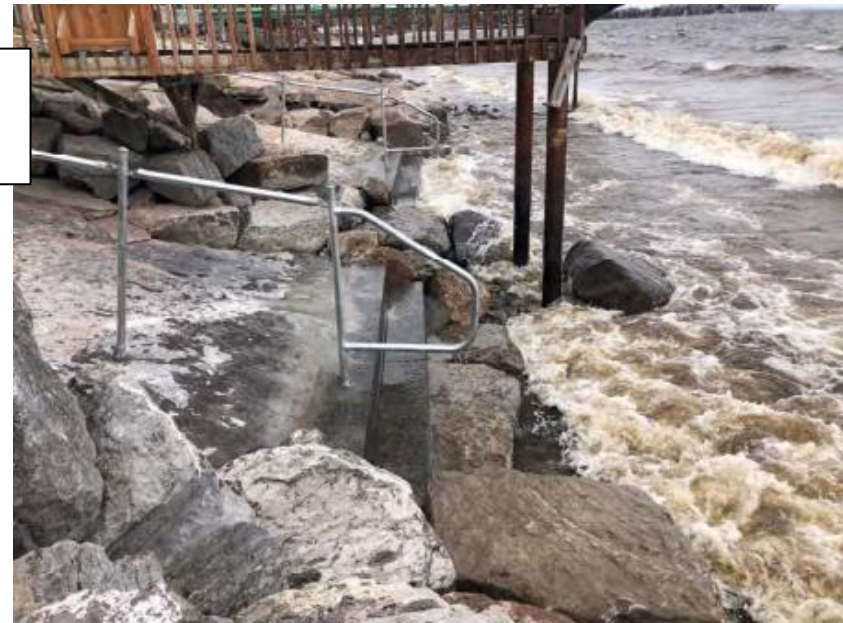
35 chemin bérubé Photo avril 2021 Niveau d'eau inconnu
